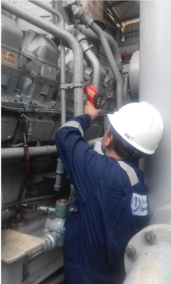
Gambar 90 Foto Pengukuran Parameter Temperatur Engine
